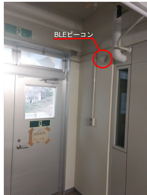
図 5.2: BLE ビーコン設置場所例 2
